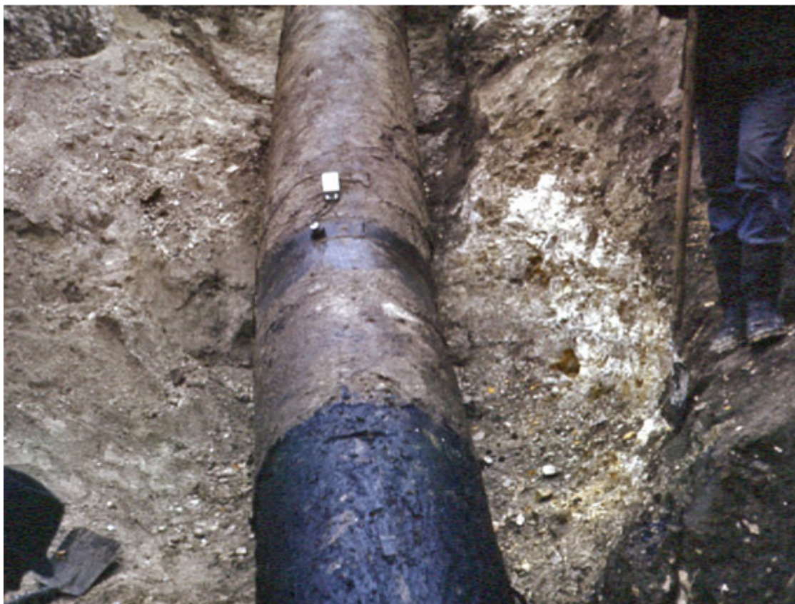
Рис. 2. Участок трубопровода, подверженный действию внешней коррозии под воздействием минералов грунта.
