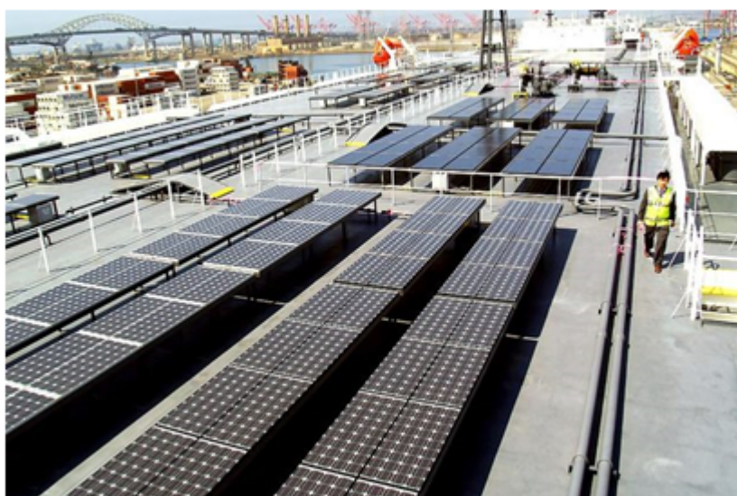
Рис. 3. Солнечные батареи установленные на палубе судна
